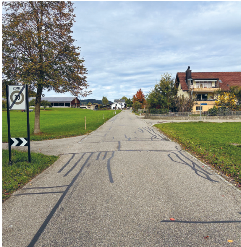
Die Hörnlistrasse befindet sich in einem schlechten Zustand und muss saniert werden. Gleichzeitig wird der Schulweg sicherer gestaltet.
