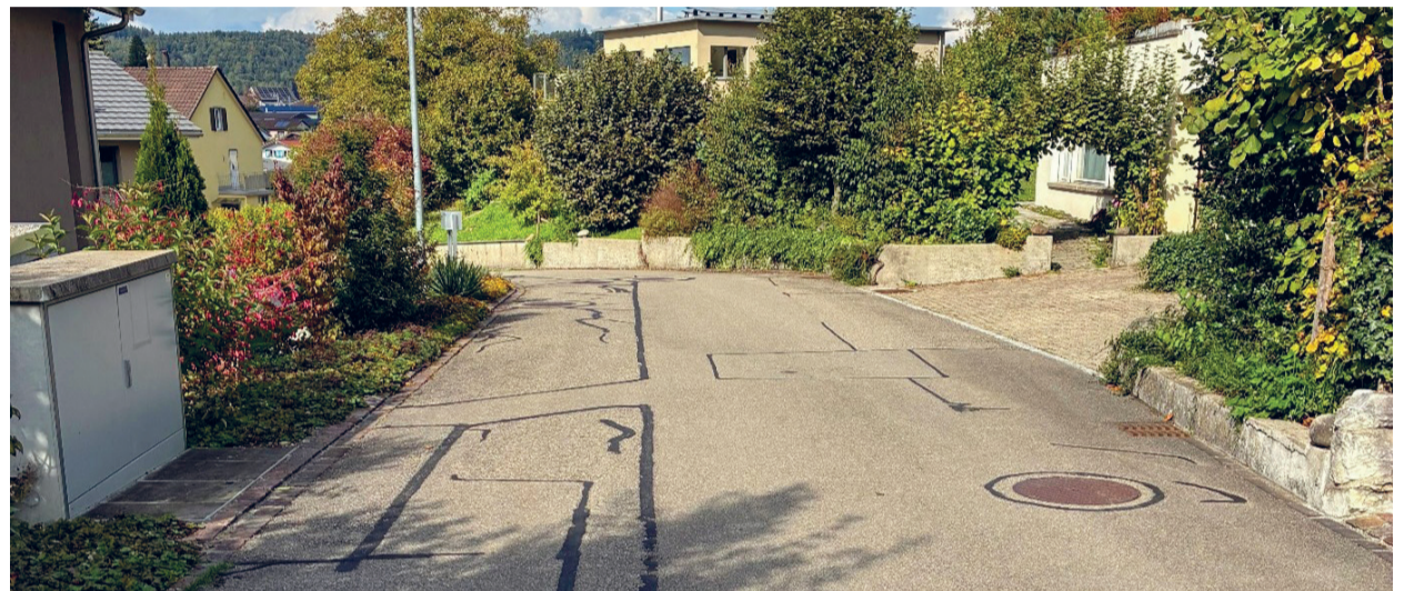
Die Oberdorfstrasse befindet sich in einem schlechten Zustand und muss saniert werden.
