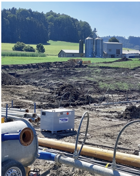
Anfang August 2023 haben bei der Industrieparzelle 392 «Riet» die Bauarbeiten für das neue Verwaltungs- und Logistikzentrum der CHRIS sports AG begonnen.
