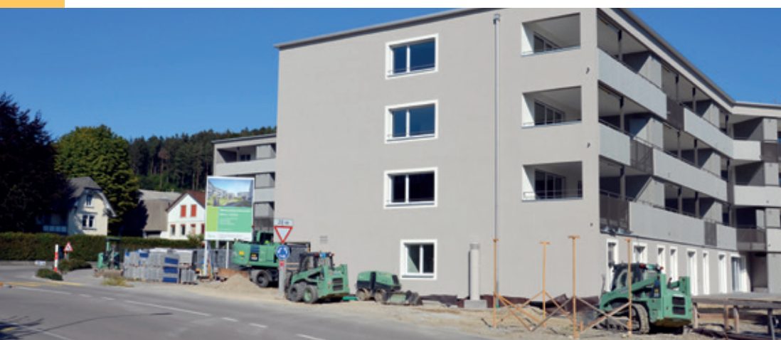
Gleichzeitig mit der Umgebungsgestaltung der Überbauung Lindenacker wird die neue Bushaltestelle erstellt.
